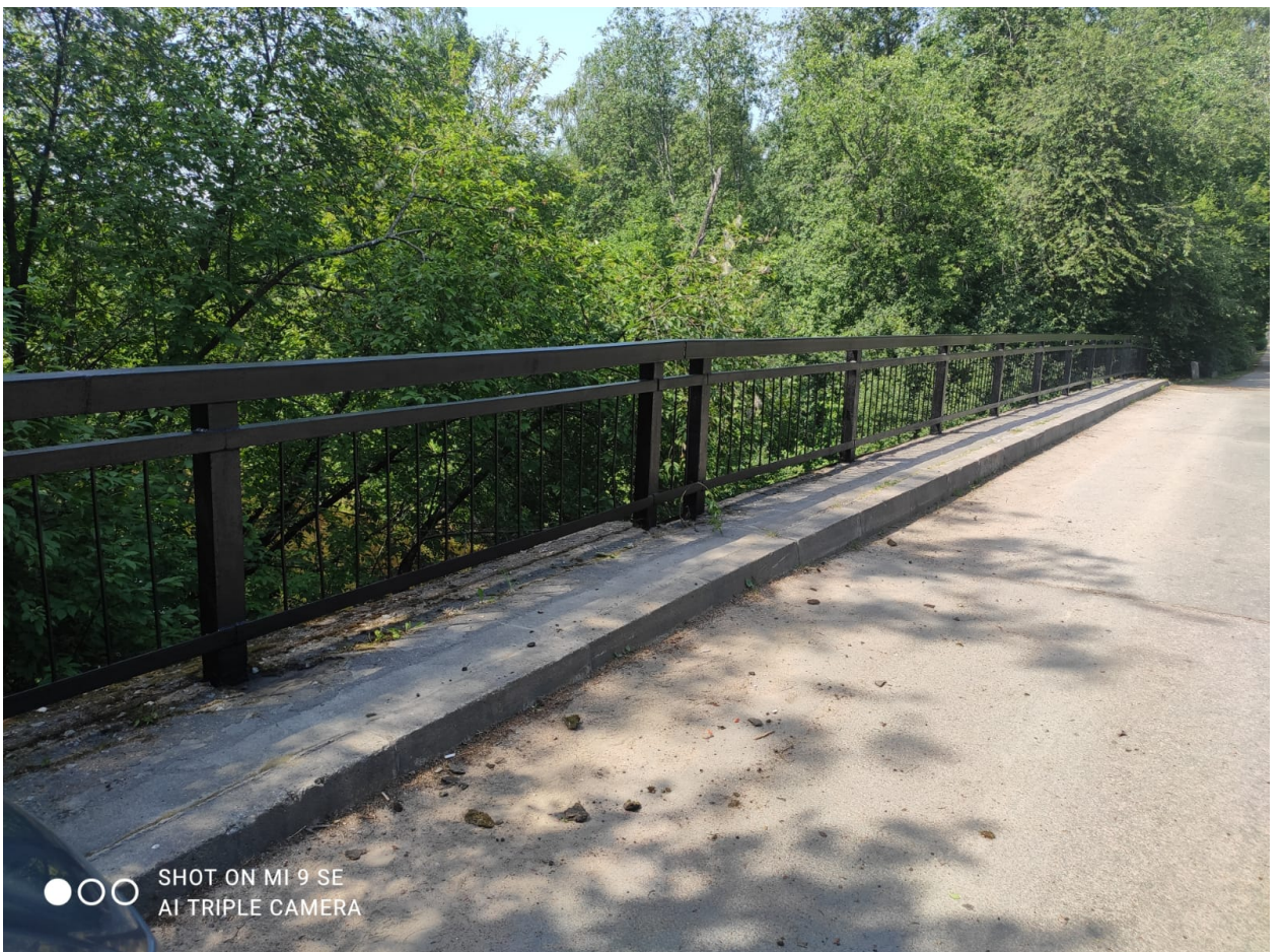
Перильное ограждение моста по ул. Главной у Александровского шоссе в Санкт-Петербург, пос. Белоостров через р. Сестру
